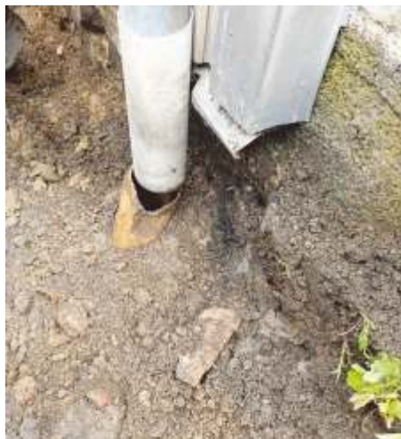
jedna z příčin vlhkosti budovy - nepřipojení svodu dešťové vody pod chodníkem
