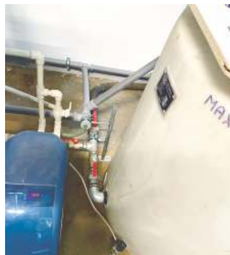
vyměněná nádrž na dopouštění upravené vody do topení
