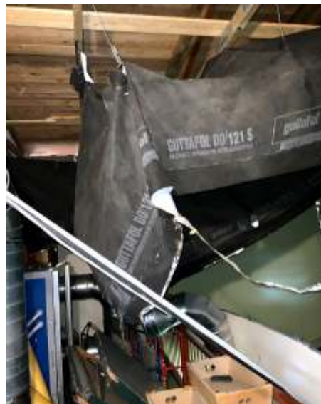
zřícený strop sportovní haly
