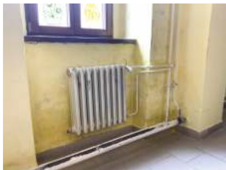
dlouhodobá vlhkost v budově MZŠ Kdyně způsobila vznik plísní
