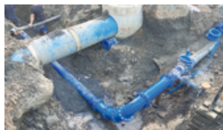
Schybka vodovodu pod kanalizací – červenec/2025
