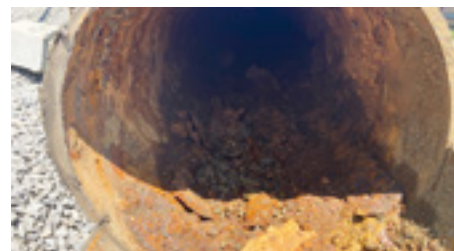
Stav starého potrubí – ocel DN 300 – červenec 2025
